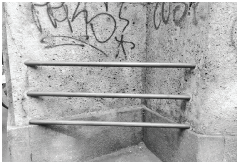
Figura 7 – Barras de metal instaladas para impedir acesso a vão de edifício
