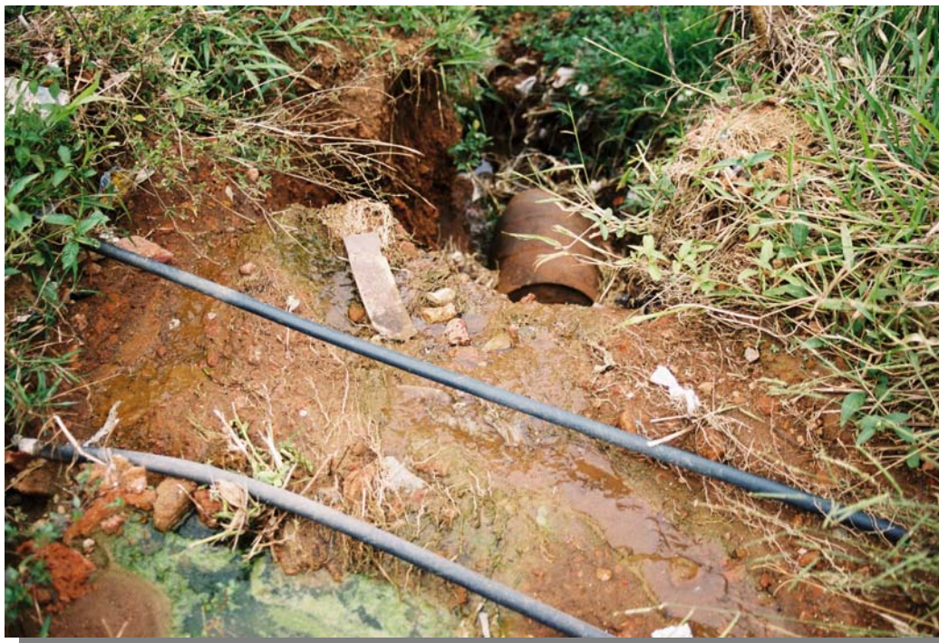
Foto 7 – Esgoto a céu aberto
